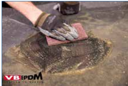
148. Reinigen der beschädigte Stelle.
