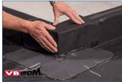
Bild 83. Falten des horizontalen Dachrandteils.
